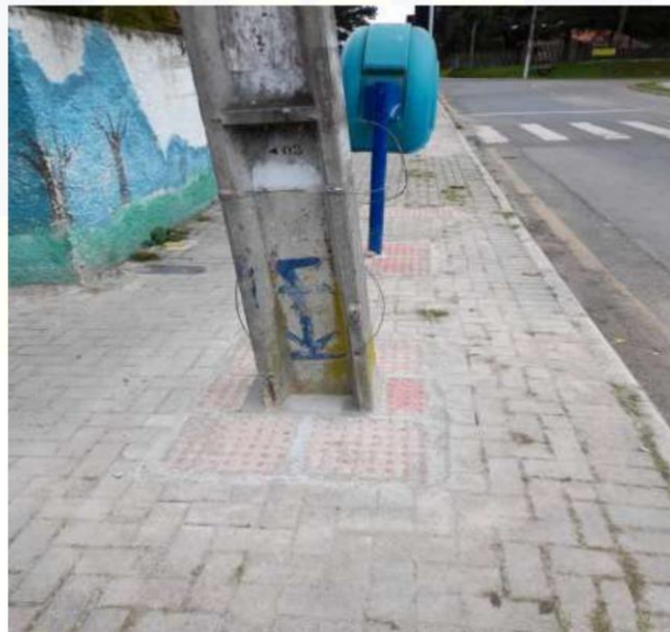
Figura 12 – Piso tátil de alerta em poste e em telefone público, localizados na Rua Henrique Gonzaga de Souza Neto. Fonte: próprio Autor, 2022
