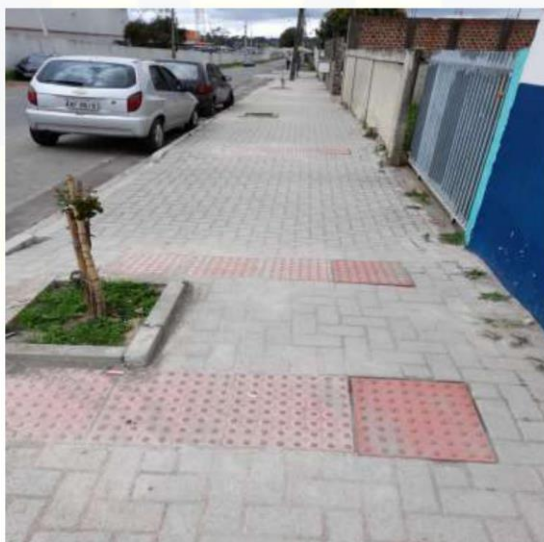
Figura 10 – Guia elevada em canteiros de árvores e piso tátil de alerta acesso de veículo, localizados na Rua Henrique Gonzaga de Souza Neto. Fonte: próprio Autor, 2022.
