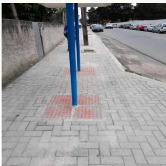
Figura 06 – Piso tátil de alerta nos pilares do ponto de ônibus localizado na Rua Henrique Gonzaga de Souza Neto. Fonte: próprio Autor, 2022.
