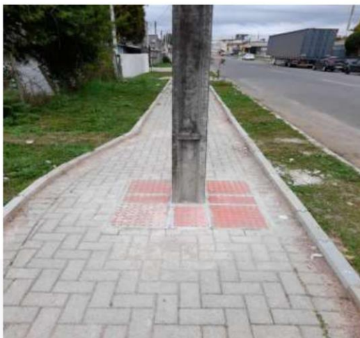
Foto 22 – Piso tátil de alerta em poste, localizado na rua Ilo Antoninho Mozer. Fonte: próprio Autor, 2022.
