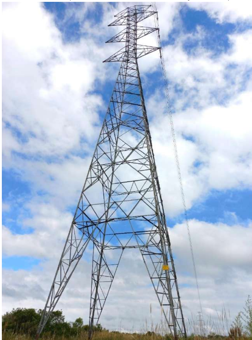
Figura 15. Torre de alta tensão para a linha de transmissão de energia elétrica que atinge o imóvel
