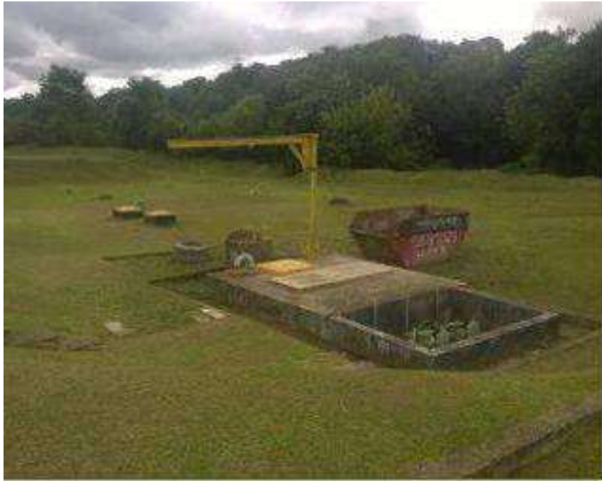
Figura 10 - Elevatória de esgoto bruto e tanque pulmão
