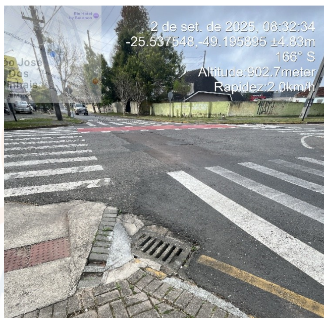
Figura 76 – Boca de lobo existente.
