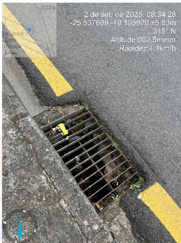
Figura 77 - Rede de drenagem existente.
