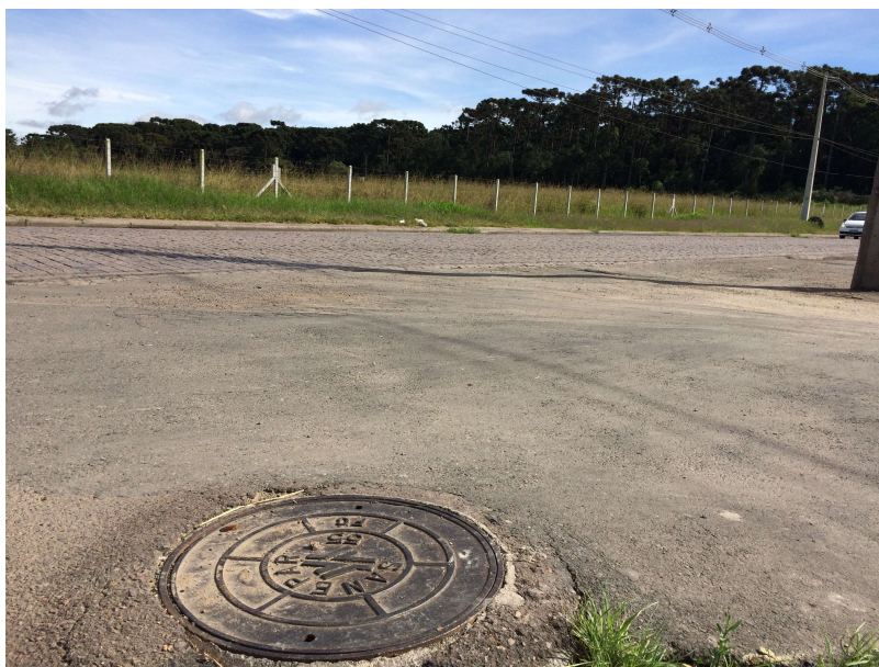
Figura 3.6. Rede de esgotamento sanitário da SANEPAR na frente do imóvel na Av. Rui Barbosa (foto anterior a ampliação da avenida)
