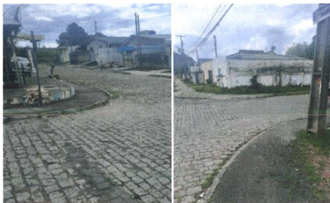
Figura 2: Rampas de acesso pendentes
