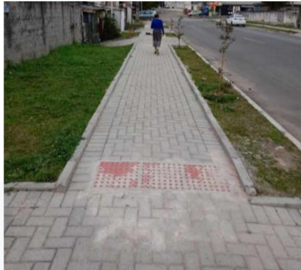
Foto 20 – Piso tátil de alerta, guias elevadas e acesso veicular, localizado na rua Ilo Antoninho Mozer. Fonte: próprio Autor, 2022.
