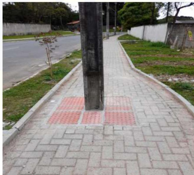
Foto 21 – Piso tátil de alerta em poste, localizado na rua Ilo Antoninho Mozer. Fonte: próprio Autor, 2022.
