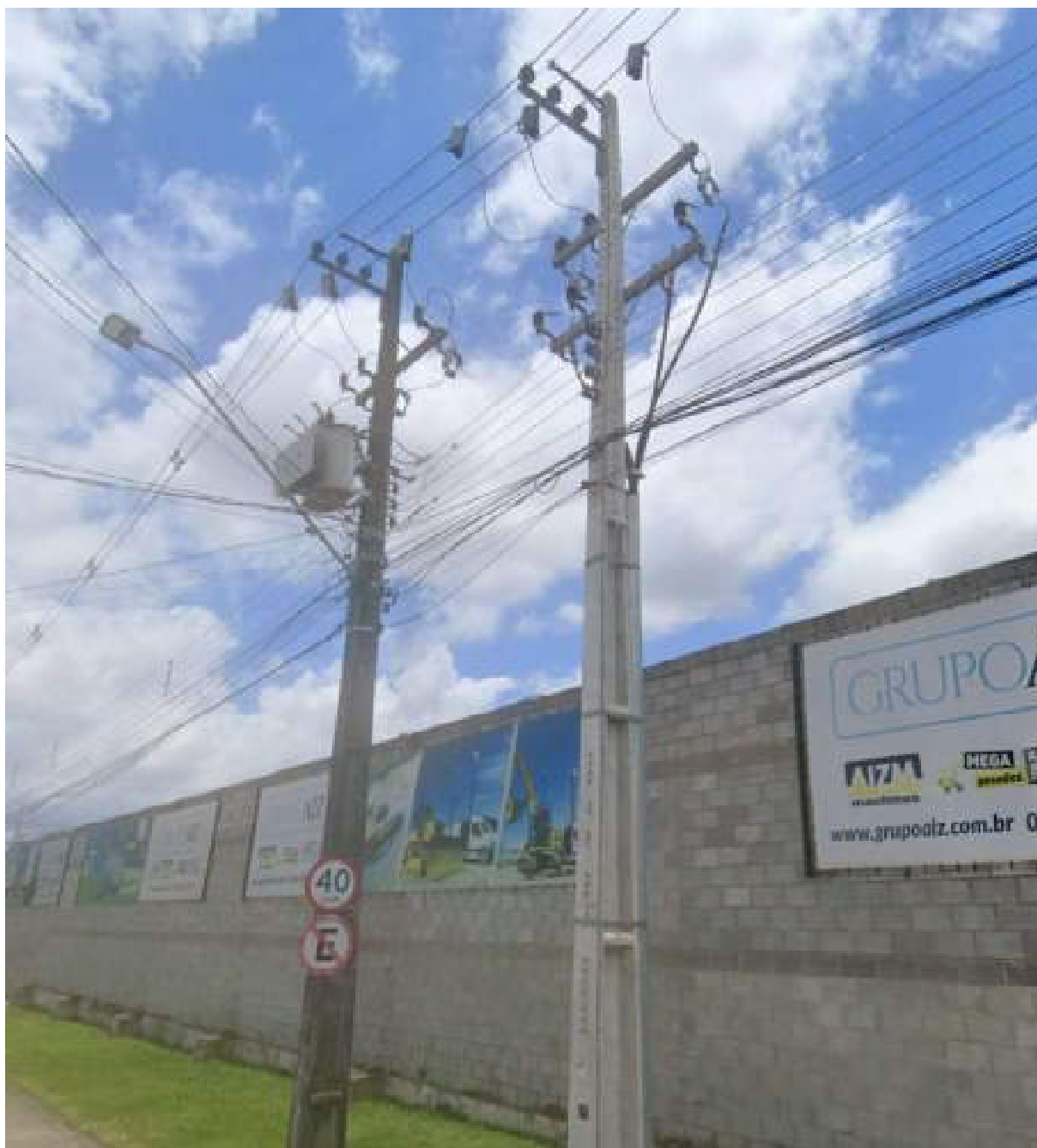
Figura 28 – Poste de energia elétrica de alta tensão
