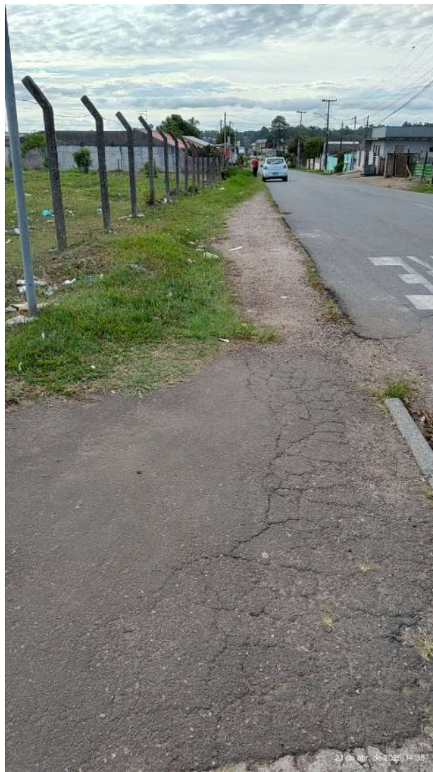
Figura 30 - Ausência de calçamento, Rua Evelize Aparecida Rosseti Mendes
