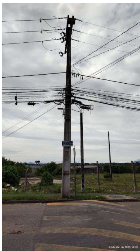
Figura 26- Serviço de iluminação pública e fornecimento de energia elétrica, Estrada da Roseira
