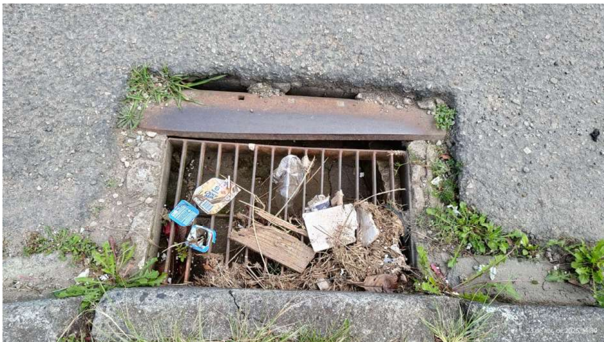
Figura 34 - Sistema de drenagem pluvial, Estrada da Roseira
