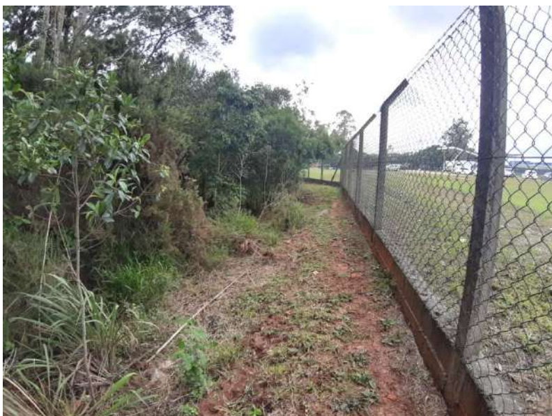
Alambrado de proteção da APP.
