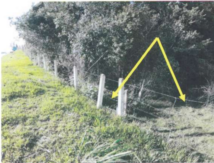
Ponto de afloramento de lençol freático.
