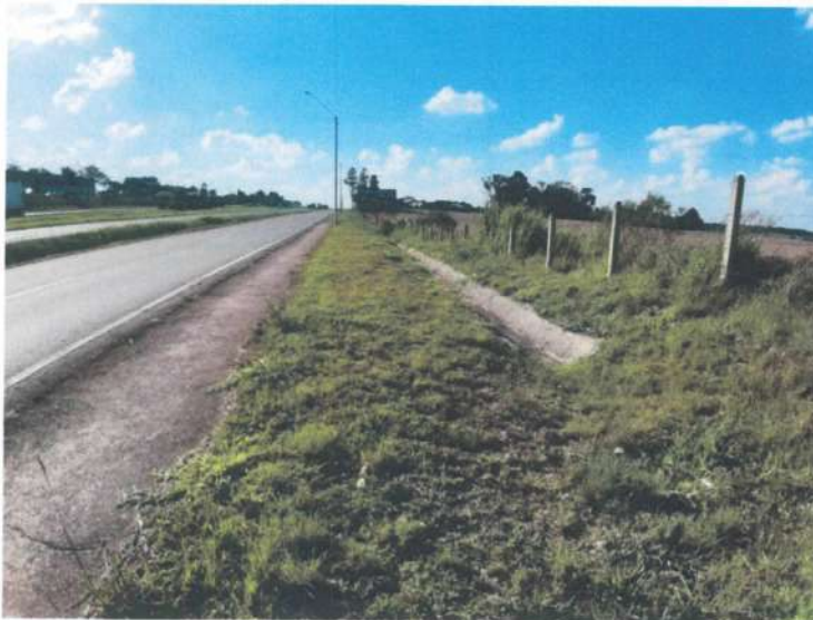
Registro de canaletas de captação de águas pluviais da pista de rolamento.
