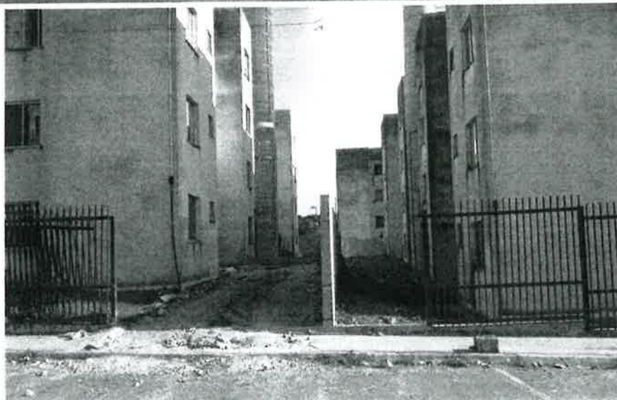
Fotos das obras do desmembramento dos Residenciais Serra do Mar I e II
