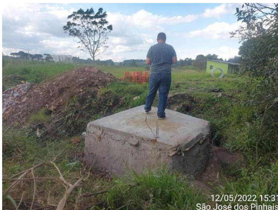
Fotografia 1 - Caixa receptora de tubulação para direcionamento às drenagens da região.
