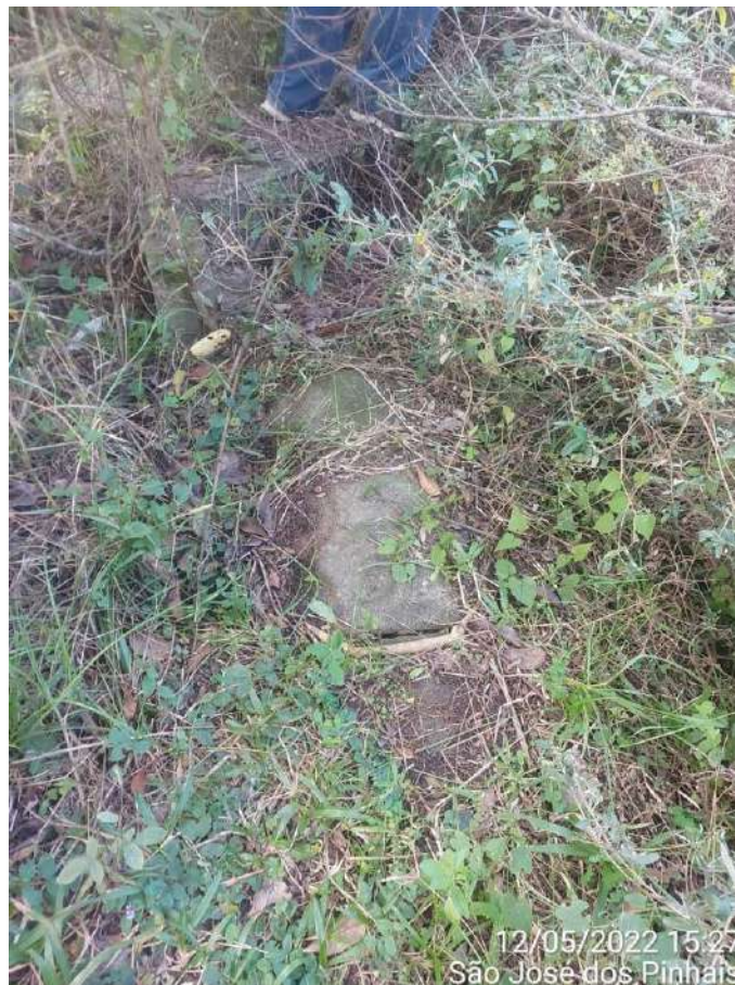
Fotografia 2 - Tubulação para escoamento da água superficial.
