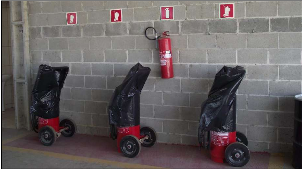
FOTO 25. – Extintores disponíveis no barracão onde fica a oficina, almoxarifado e tanque de óleo diesel.
