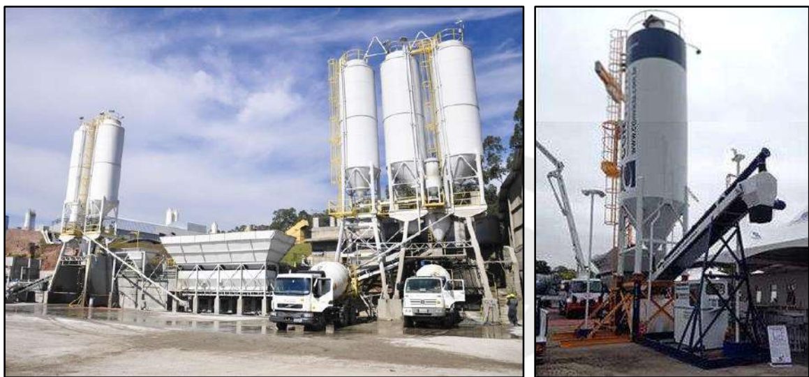
FIGURA 11 – USINA MISTURADORA E DOSADORA DE CONCRETO
