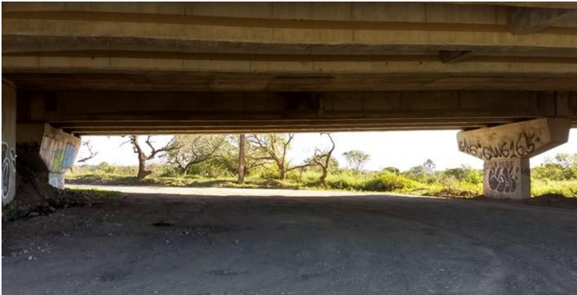
Figura 15 - Passagem sob Viaduto da Av. Marechal Floriano. Trecho sem pavimentação. Fonte: Monitore Engenharia
