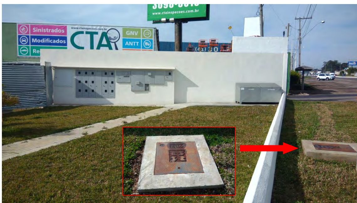
Foto 11 - Ligação elétrica da COPEL já existente, assim como local para disposição dos resíduos sólidos comuns e recicláveis
