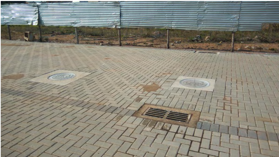
Foto 08 - Rede de drenagem de águas pluviais
