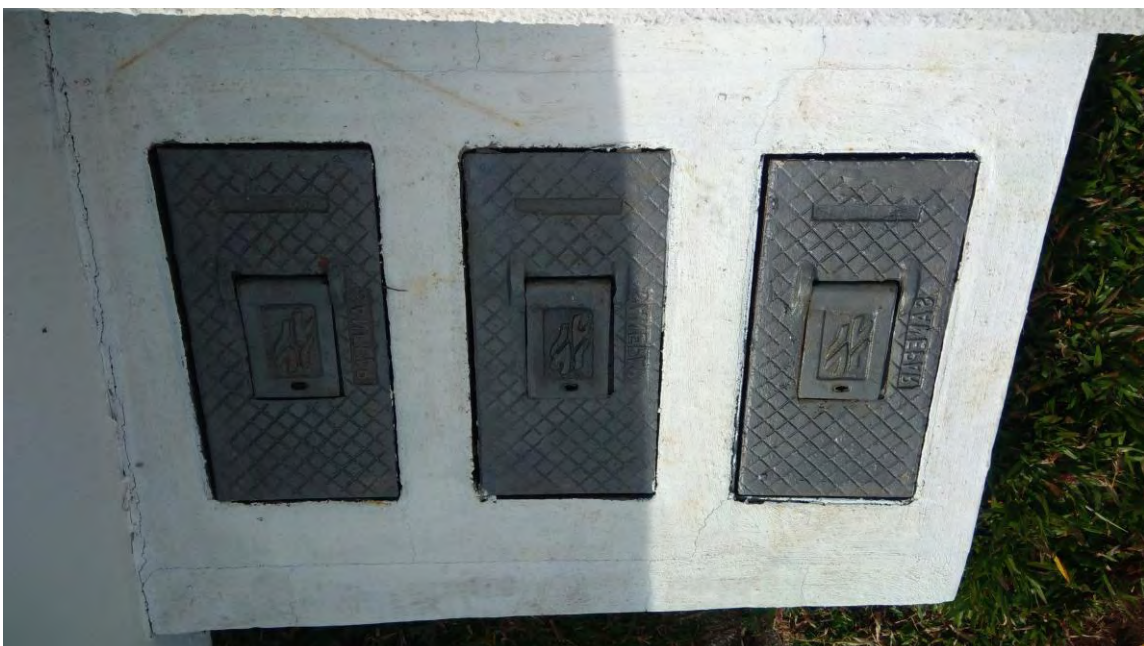
Foto 09 - Ligação da SANEPAR – Hidrômetros
